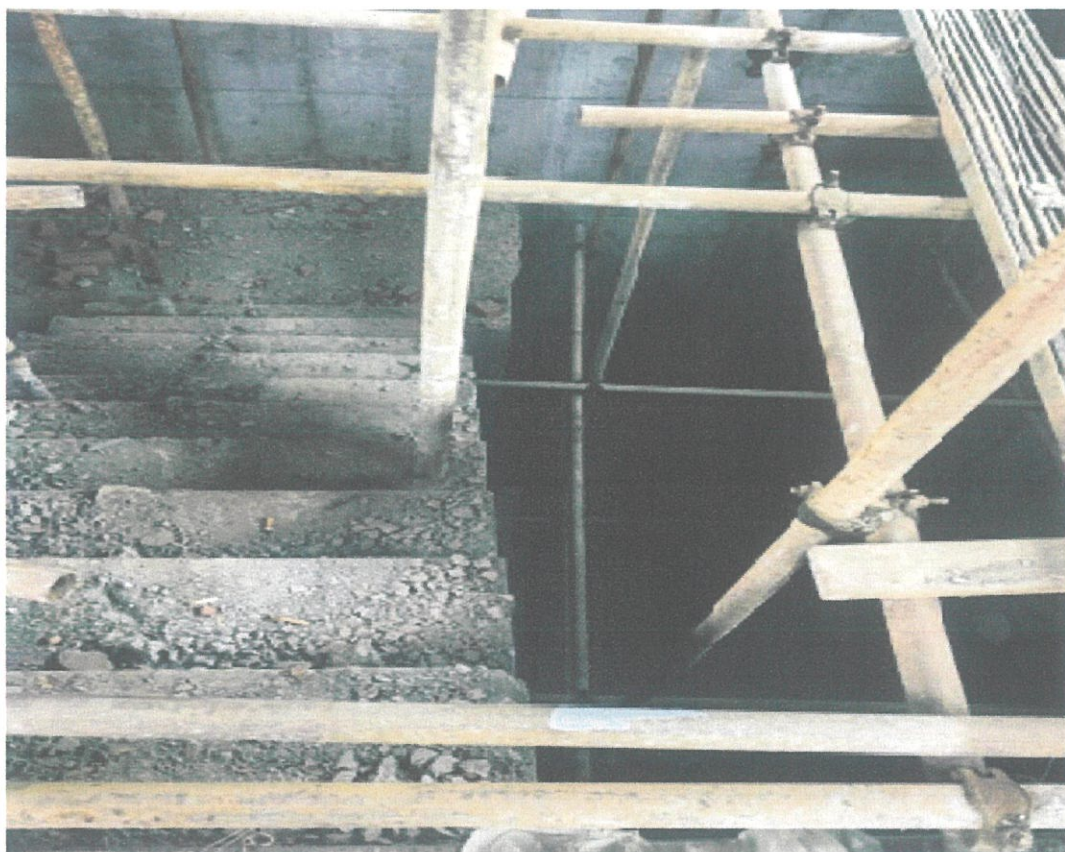
整改前：泵房内楼梯梯段及泵房平台无防护。
